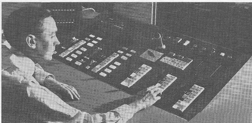
Het regel- en controlepaneel van de Q-File installatie in studio 8 van het BBC-TV-centrum.
